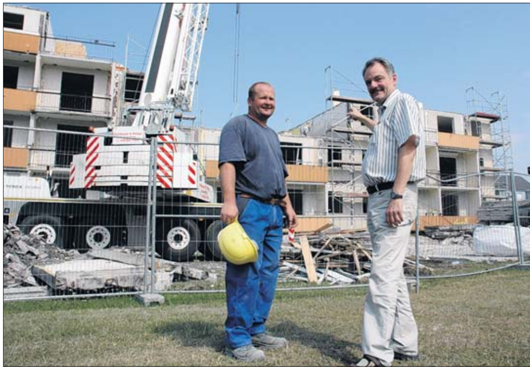
Gerhard Thiede (re.), Geschäftsführer der Wolmirstedter Wohnungsbaugesellschaft, bespricht mit Polier René Prüß den Fortschritt beim Rückbau der Fünfgeschosser in der Geschwister-Scholl-Straße. Foto: C. Labude
